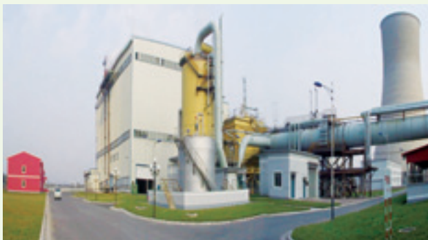
鞍山钢铁第二发电厂 CCPP 机组
