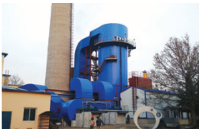
东烧厂锅炉烟气脱硫
