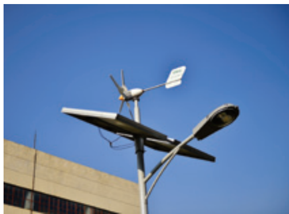
攀钢钒资源利用中心安装的 LED 节能灯
