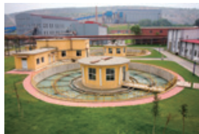
污水循环利用处理系统
